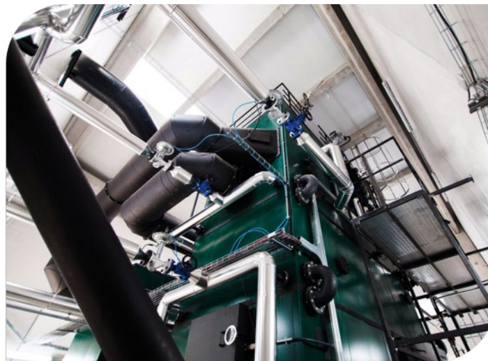
Calderas de vapor saturado
